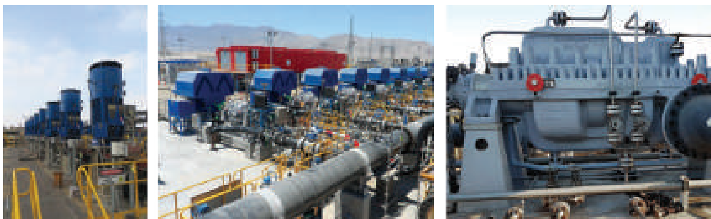
Estaciones de bombeo para agua de mar en Chile.
