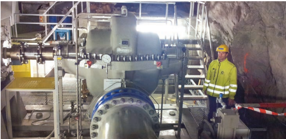
Bomba modelo ZM instalada en mina bajo tierra en Noruega.
